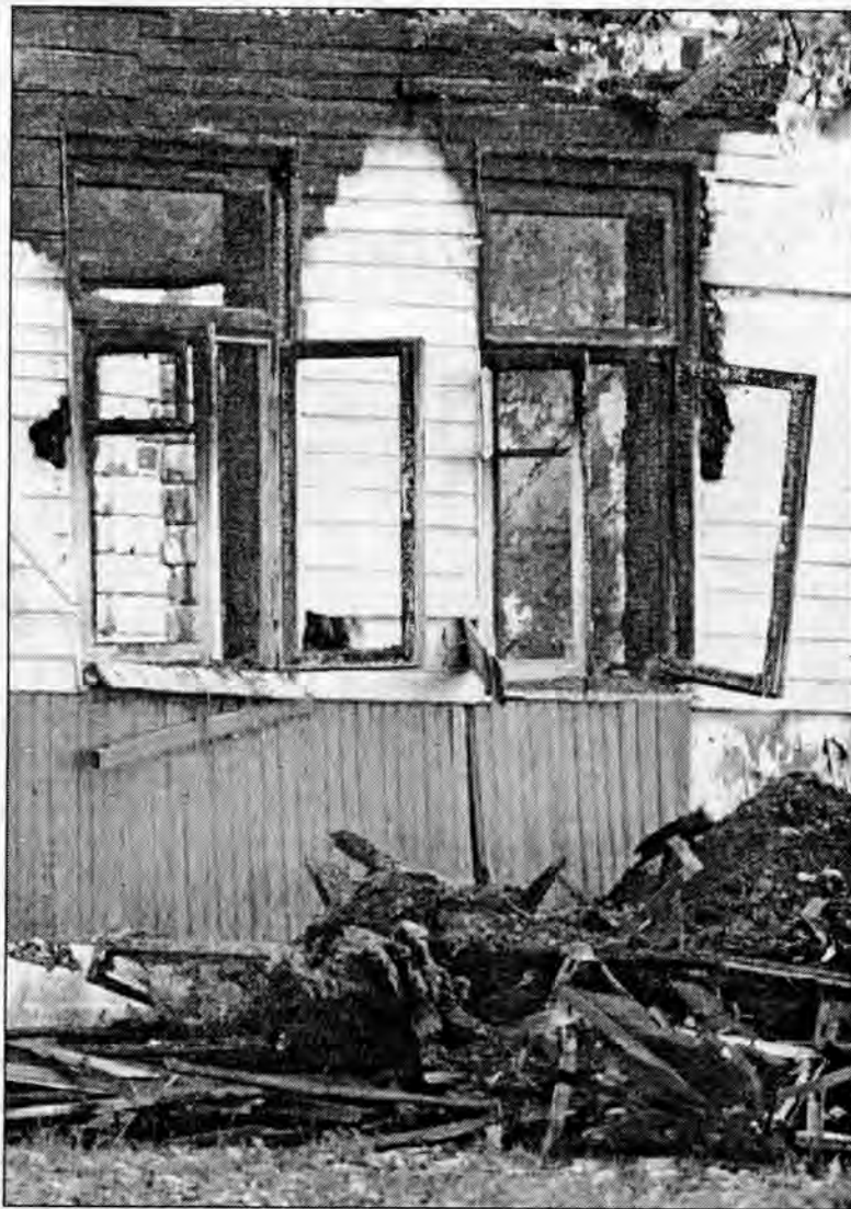
Сгоревшее строение Козловичского дома-интерната для душевнобольных, Дятловский район, Гродненская область, 13 октября 2003 года
